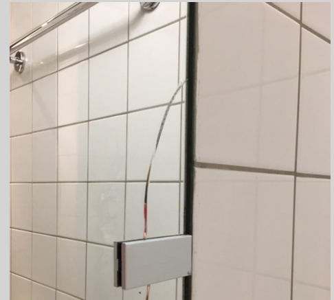
Defekter Spiegelschrank (Foto:AG)
