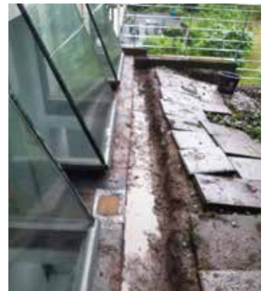
Schäden an den Bodenplatten
